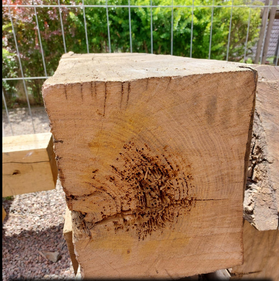
Scheinbar gesunder Balken Erst Pilzbefall, dann gefleckter Nagelkäfer.
